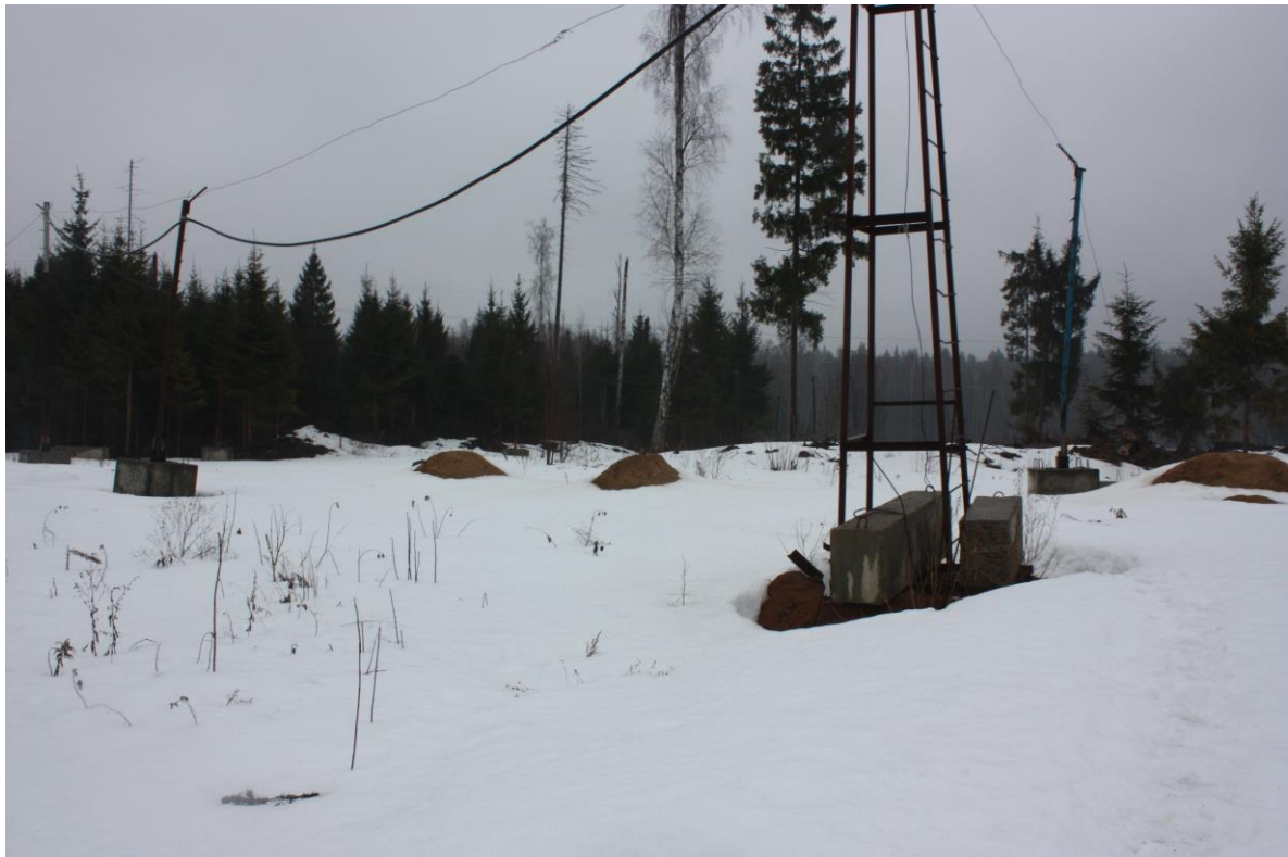
Рис. 3.1.1. Общий вид временного электроснабжения
